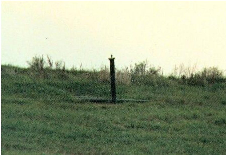
Fig. 24 - Camino di aspirazione del biogas
