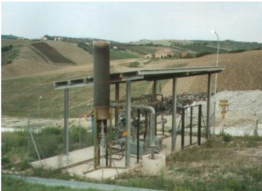
Fig. 20 - Torcia per il biogas
