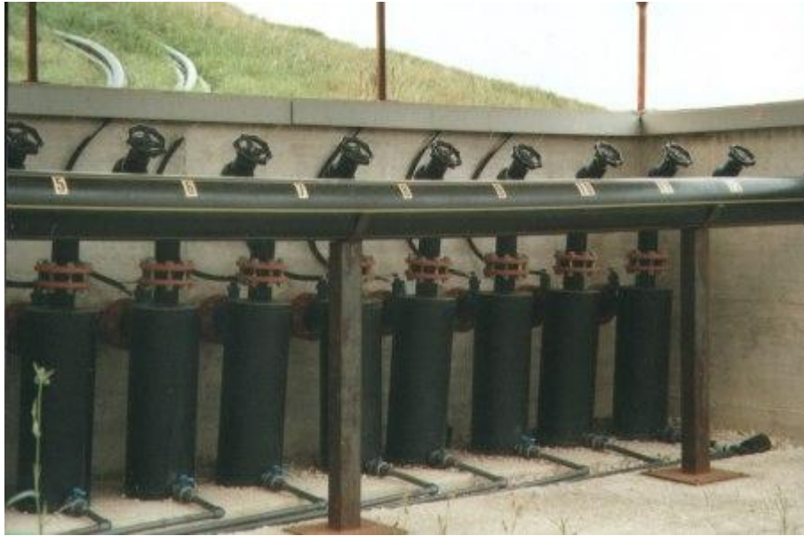
Fig. 19 – Sottostazione di trattamento con separatori di vapore
