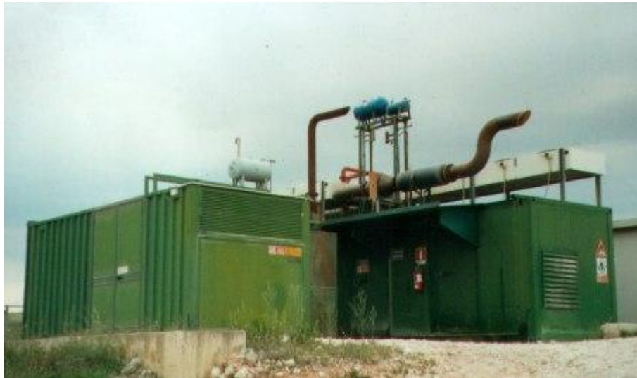
Fig. 18 - Centrale per la generazione di energia elettrica dal biogas
